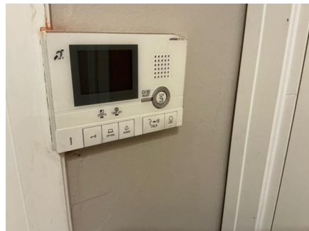
Dørcalling med monitor er plassert i entre.
