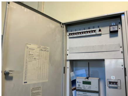
Automatsikringer i sikringsskap plassert i gang/fellesareal.
