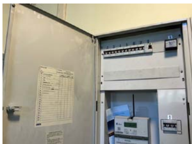
Automatsikringer i sikringskap plassert i gang/fellesareal.
