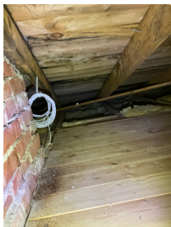
Misfarging i undertak på kaldloft.
