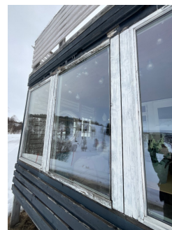
Vinduer i innebygget veranda er spesielt slitte
