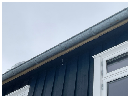
Rusthull og lekkasjer i enkelte takrenner.
