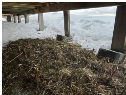
Skjevheter i fundamenter under innebygget veranda.
