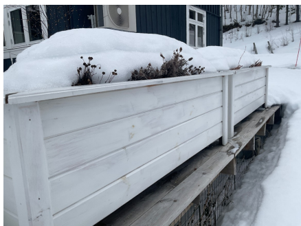
Mangler rekkverk ved deler av terrasse.
