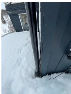
Frostspreng i enkelte taknedløp.
