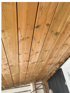
Fuktskjolder i tak i innebygget veranda.
