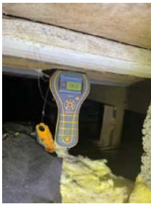
Målt fukt over grensen for utvikling av sopp/råte
