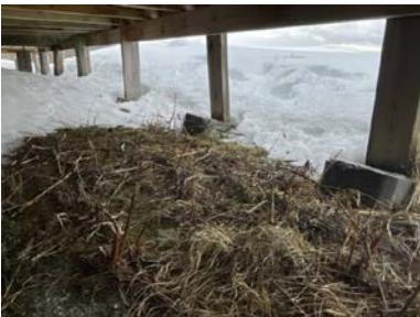
Skjevheter i fundamenter under innebygget veranda.
