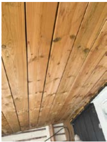
Fuktskjolder i tak i innebygget veranda.
