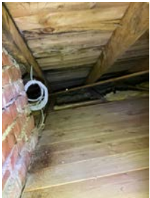
Misfarging i undertak på kaldloft.
