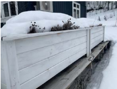
Mangler rekkverk ved deler av terrasse.
