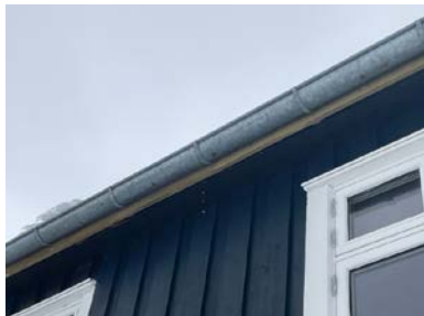
Rusthull og lekkasjer i enkelte takrenner.
