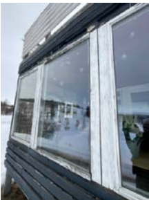
Vinduer i innebygget veranda er spesielt slitte
