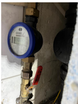
Hovedvanninntak i rørkasse vaskerom/bad kjeller.
