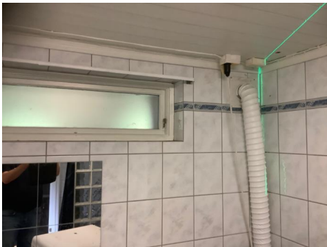
Ventil i vegg er tilkoblet tørketrommel.
