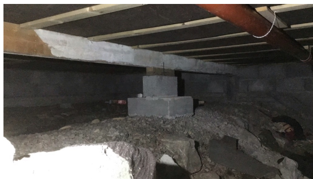
Gulv under tilbygg
