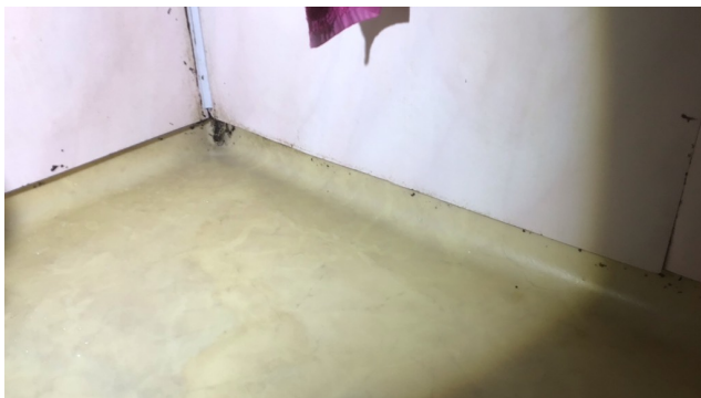
skader i nedkant våtromsplater i dusj
