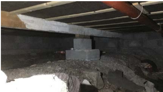
Gulv under tilbygg
