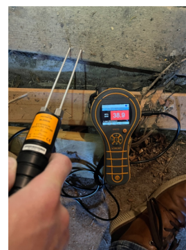
Organisk materialer mot grunn trekker til seg fuktighet.
