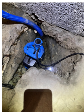
Dreneringspumpe i nyere del av kjelleren, vannspeil synlig
