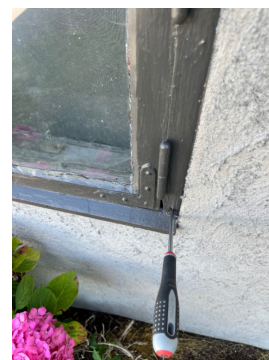
Råteskadet karm i kjellervindu
