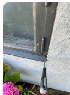
Råteskadet karm i kjellervindu
