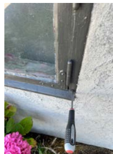
Råteskadet karm i kjellervindu
