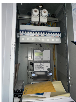
Sikringsskap med skru/automatsikringer.
