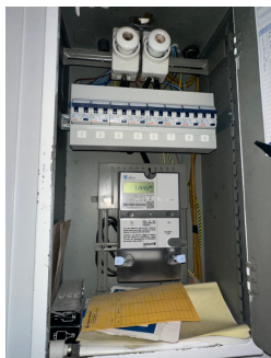
Sikringsskap med skru/automatsikringer.
