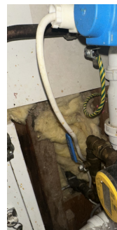
Stoppekraner plassert på kjøkken
