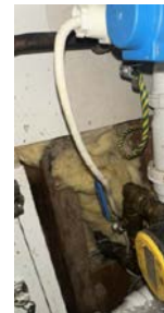
Stoppekraner plassert på kjøkken
