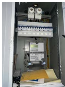
Sikringsskap med skru/automatsikringer.
