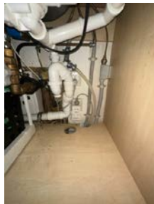
Røropplegg i kjøkkenbenk med Waterguard
