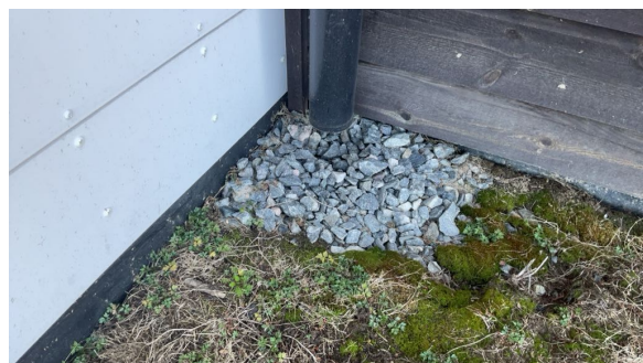
Utløp for regnvann er avsluttet rett ved ringmur.
