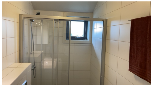
Vindu nær dusj er plassert i våtsone
