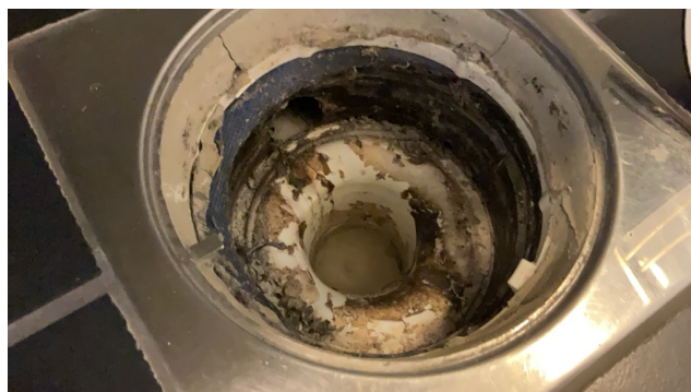
Fra hjelpesluk var det synlig tettesjikt under klemring
