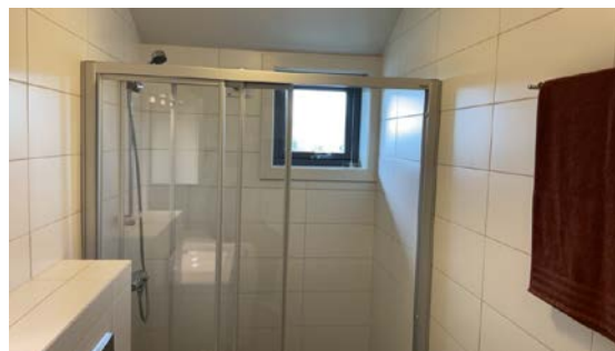
Vindu nær dusj er plassert i våtsone
