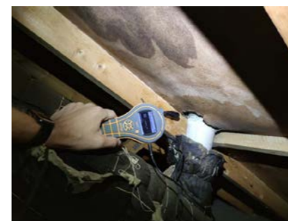
Eldre fuktskjolder rundt luftehatt. Ikke målt noe unormalt med fukt.
