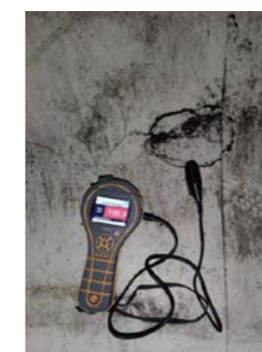
Høye fuktverdier i tilfarergulv i bod under trapp.
