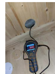
Målt høye fuktverdier i bunnsvill.
