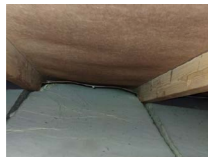
Lite luft i nedre del av konstruksjon.
