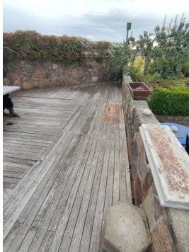
Platting med omfattende skjevheter og råteskader.
