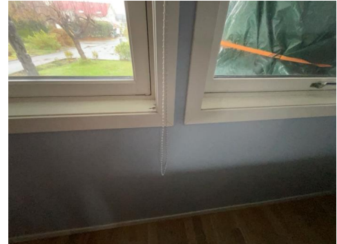
Høyt fuktnivå i disse to vinduene.
