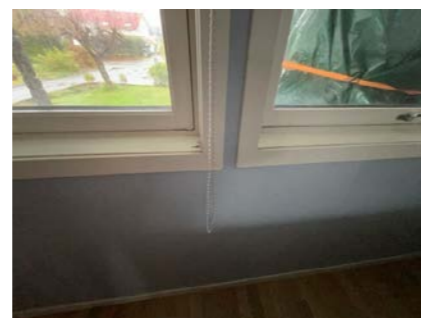
Høyt fuktnivå i disse to vinduene.
