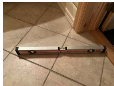
Motfall på deler av gulvet.
