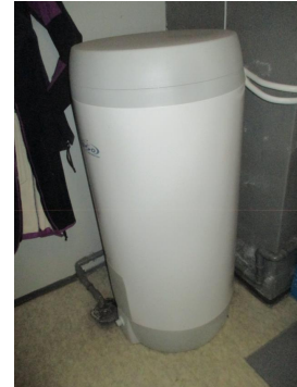
Nyere bereder er plassert på vaskerommet.
