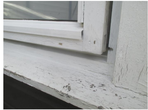
Trenger utvendig vedlikehold.
