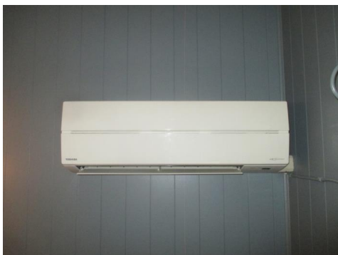
Varmepumpe i trappegangen.
