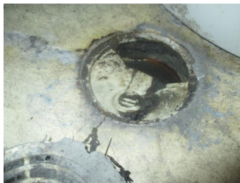
Sluk ved bereder.
