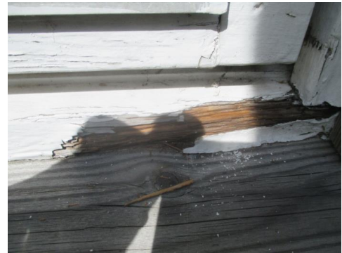
Utvendig skade på karm.
