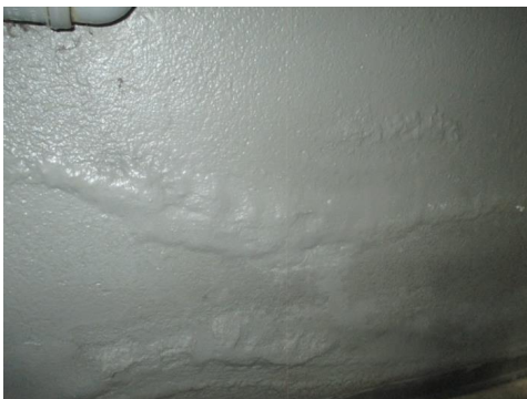
Noe fuktvendig i grunnmur på vaskerommet.
