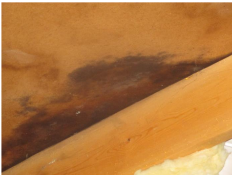
Eldre fuktmerker i rundt luftehatt.
