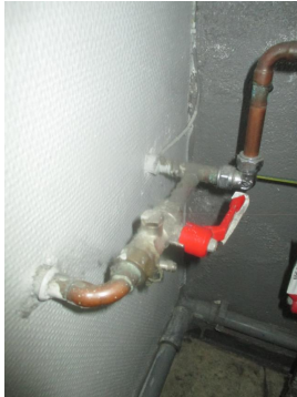
Innendig stoppekran bak bereder på vaskerommet.
