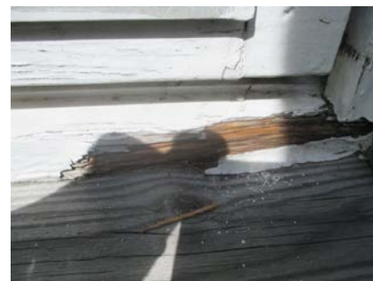
Utvendig skade på karm.
