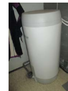
Nyere bereder er plassert på vaskerommet.
