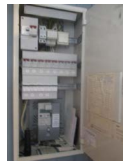
Sikringsskapet er plassert i entren.
