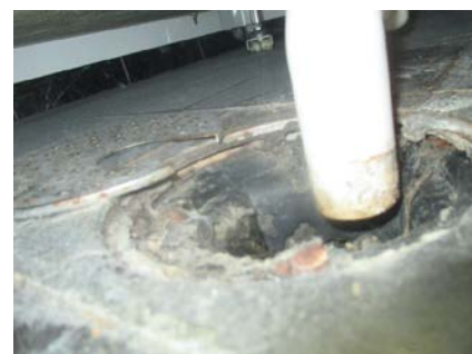
Sluk under dusjkabinett.
