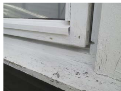
Trenger utvendig vedlikehold.
