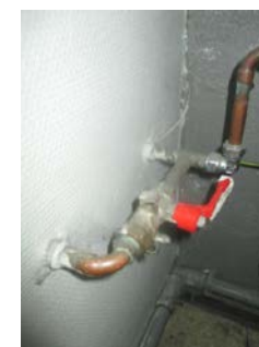
Innvendig stoppekran bak bereder på vaskerommet.
