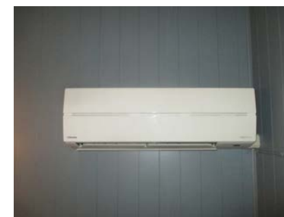
Varmepumpe i trappegangen.
