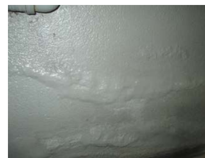
Noe fuktvendig i grunnmur på vaskerommet.
