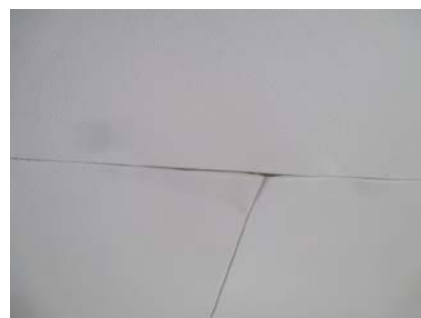
Fuktmerker og svelling i skjøter.
