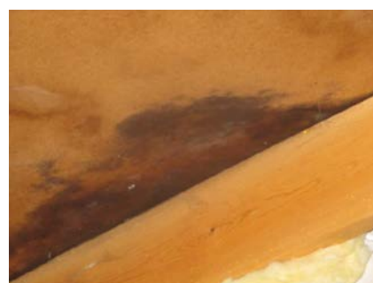
Eldre fuktmerker i rundt luftehatt.
