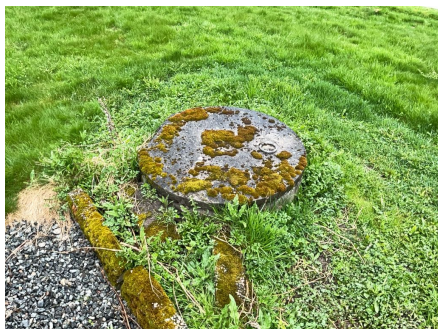
Kumlokk til tanken.
