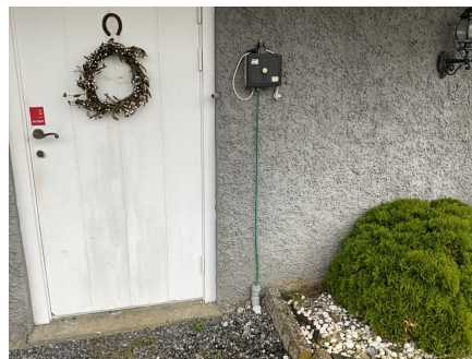
Det er varslingsanlegg tilknyttet tanken
