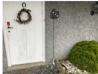
Det er varslingsanlegg tilknyttet tanken
