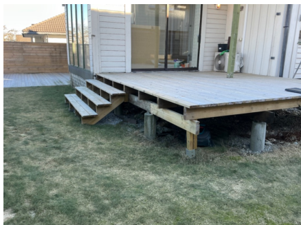
Rekkverk er ikke etablert.
