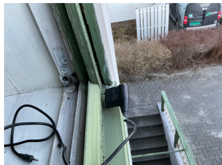
Fukt/råteskade på vindu på loft.
