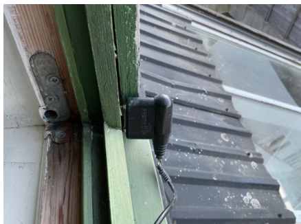
Fukt/råteskade på vindu på loft.
