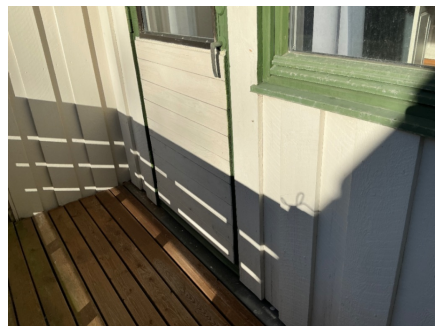
Terrassedøren fra soverom er kledd utenpå. Bytte av dør må påregnes.
