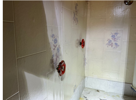
Hovedstoppekran står i bad i kjeller
