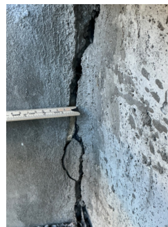
Sprekk i trapp mellom grunnmur.
