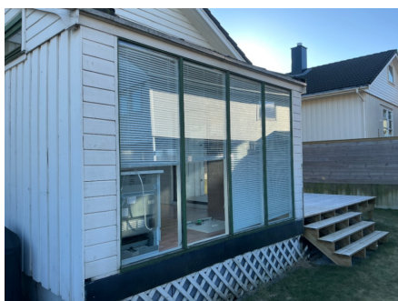
Fukt/råteskade på vindu til hage
