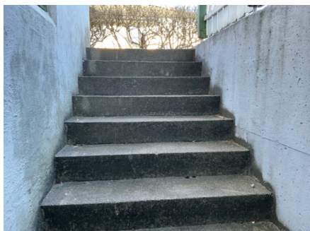
Hånd-rekke er ikke etablert.
