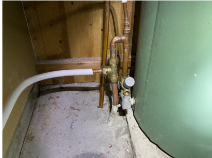
Vannrør ved bereder er ikke fagmessig utført.
