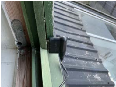
Fukt/råteskade på vindu på loft.
