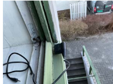
Fukt/råteskade på vindu på loft.
