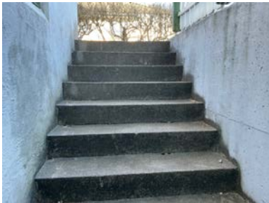
Hånd-rekke er ikke etablert.
