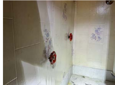
Hovedstoppekran står i bad i kjeller
