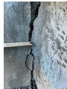
Sprekk i trapp mellom grunnmur.
