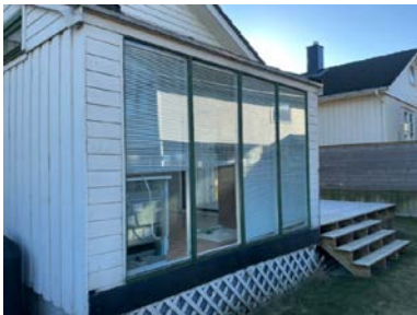
Fukt/råteskade på vindu til hage
