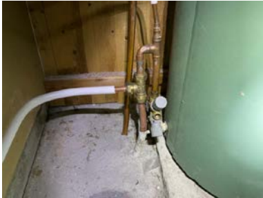
Vannrør ved bereder er ikke fagmessig utført.
