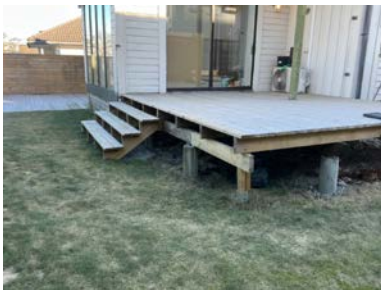
Rekkverk er ikke etablert.
