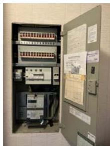
Sikringsskap står i entre 1 etasje.
