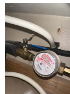
Stoppekraner plassert på bad
