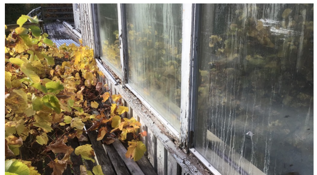
Råte skader i vinduer
