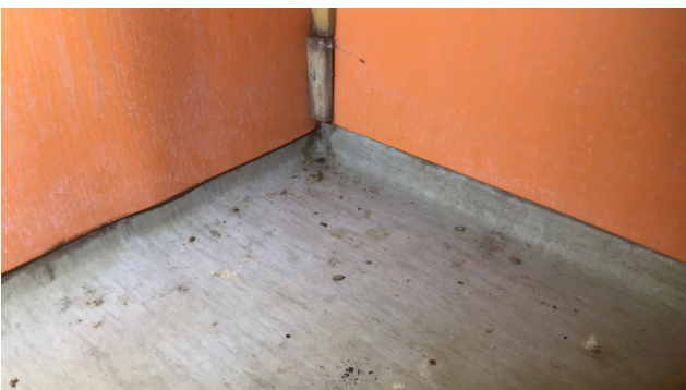
Fukt skader i dusj
