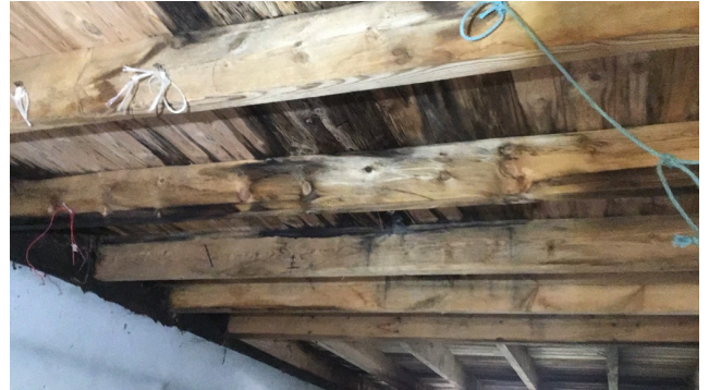
Råte/fuktskader i tak
