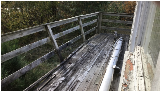
Store skader og skjevhet i rekkverk
