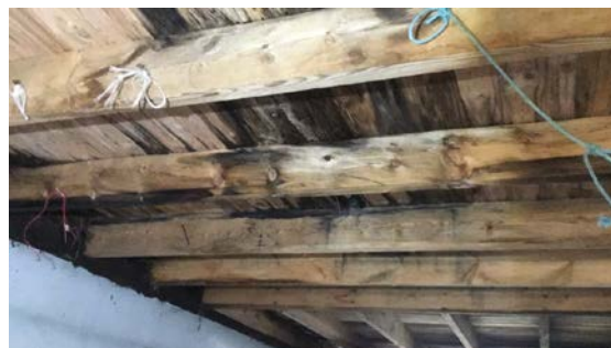
Råte/fuktskader i tak
