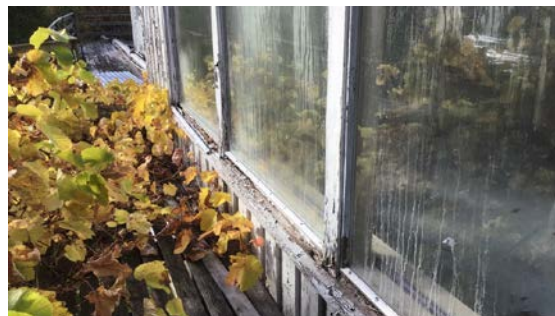
Råte skader i vinduer
