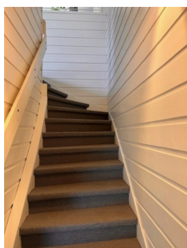
Trapp mangler håndløper på vegg.
