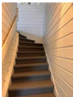
Trapp mangler håndløper på vegg.
