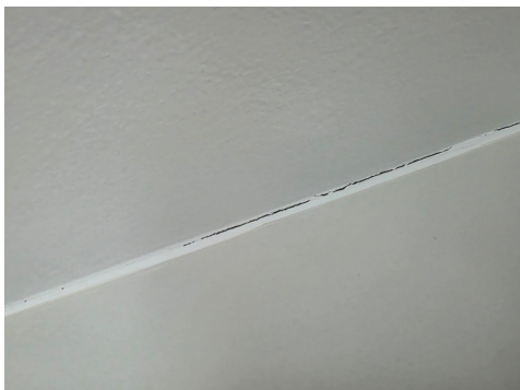
Sprekker i fug i overgang tak-vegg
