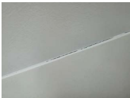
Sprekker i fug i overgang tak-vegg
