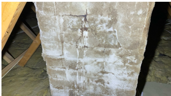
Sprekk i pipe på loft.
