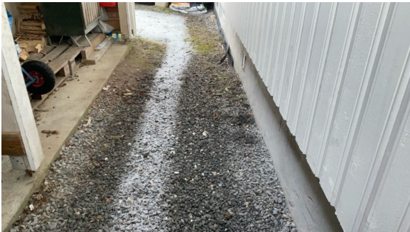
Lokalt fall mot grunnmur ved garasjen
