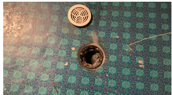
Sluk i gulv.
