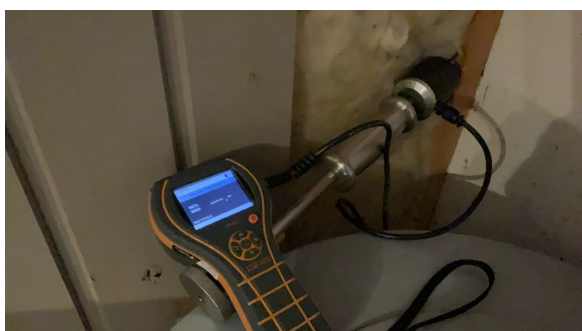
Fuktmåling i treverk mot yttervegg.
