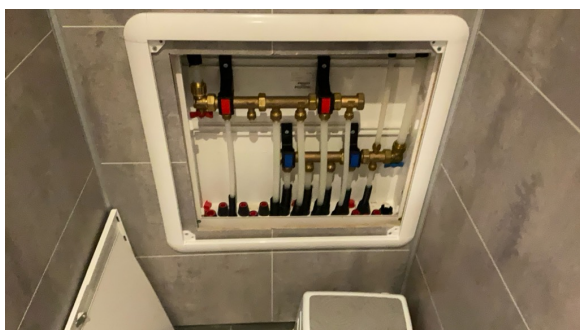
Vannskap på bad i kjelleren.
