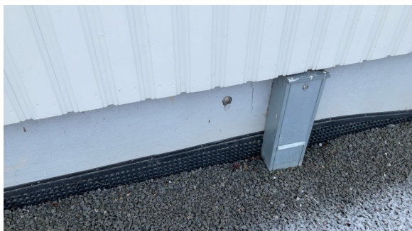
Sprekk/riss i grunnmur.
