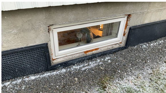
Kjellervindu ikke ferdig utvendig.
