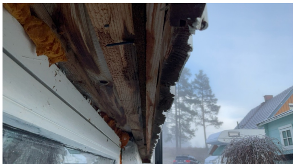
Ingen lufting i nedre kant
