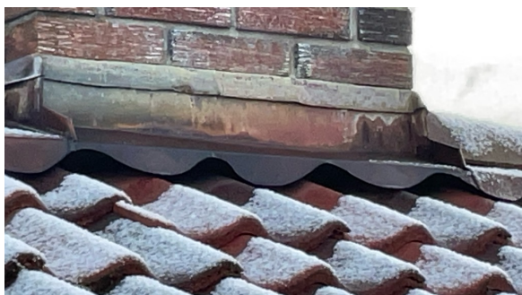
Noe rust på bunnbeslag på pipen
