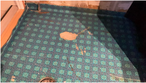
Skade i våtromsbelegg.
