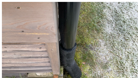
Frostsprengning på nedløpsrør.
