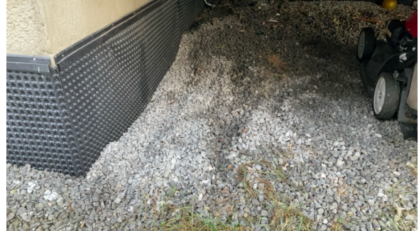
Lokalt fall mot grunnmur.
