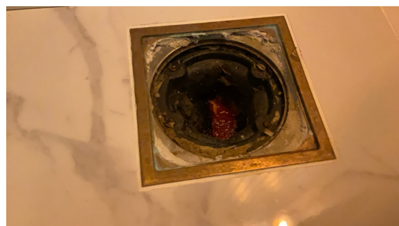
Sluk i gulv.
