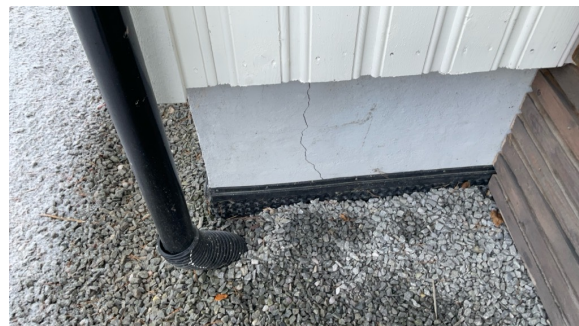
Sprekk i grunnmur.
