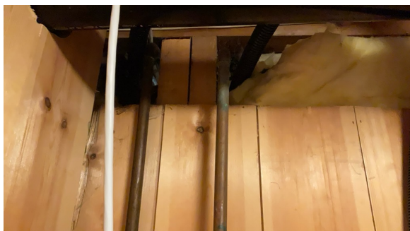
Noe irr på vannrør i kobber.
