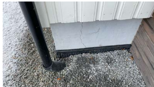
Sprekk i grunnmur.
