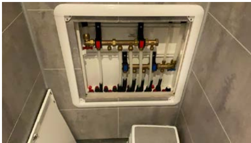
Vannskap på bad i kjelleren.
