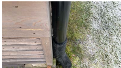
Frostsprengning på nedløpsrør.
