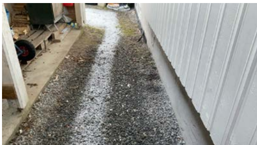
Lokalt fall mot grunnmur ved garasjen
