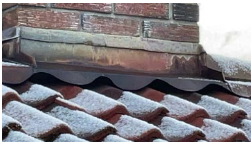
Noe rust på bunnbeslag på pipen
