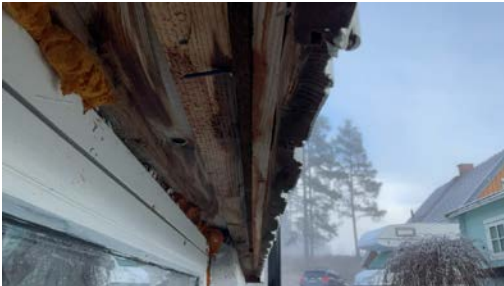
Ingen lufting i nedre kant
