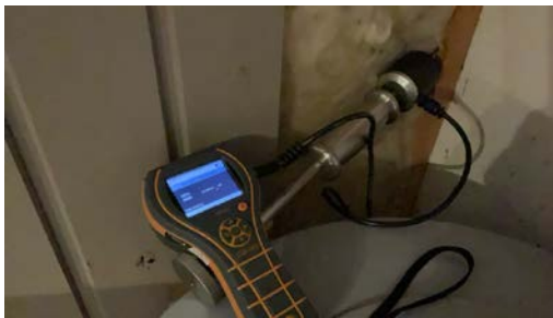
Fuktmåling i treverk mot yttervegg.
