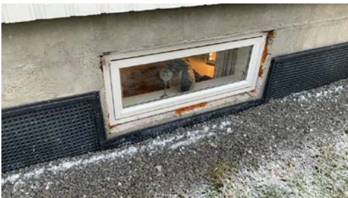
Kjellervindu ikke ferdig utvendig.
