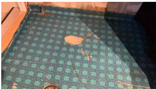
Skade i våtromsbelegg.
