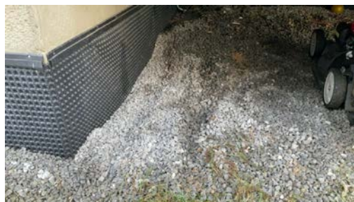
Lokalt fall mot grunnmur.
