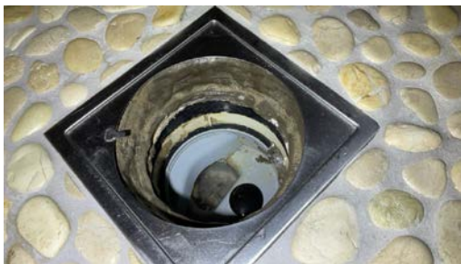
Sluk i dusjsonen.
