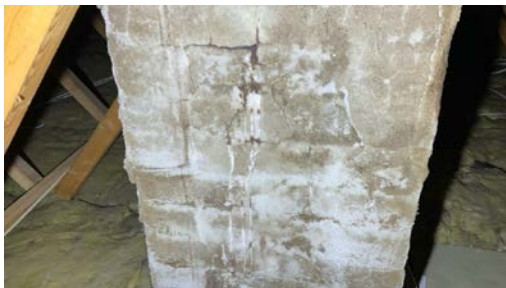
Sprekk i pipe på loft.
