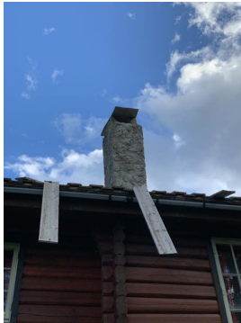
Pipeløp bør beslås med nytt beslag.
