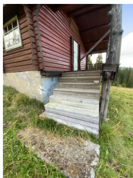
Synlig elde, slitasje og skjevheter på trapper.
