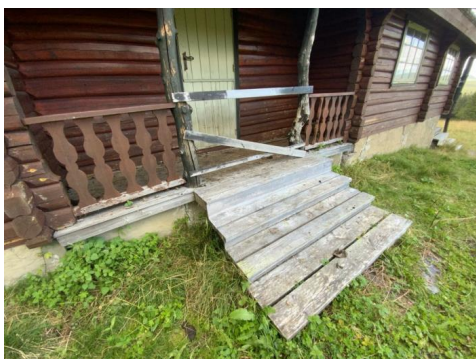
Synlig elde, slitasje og skjevheter på trapper.
