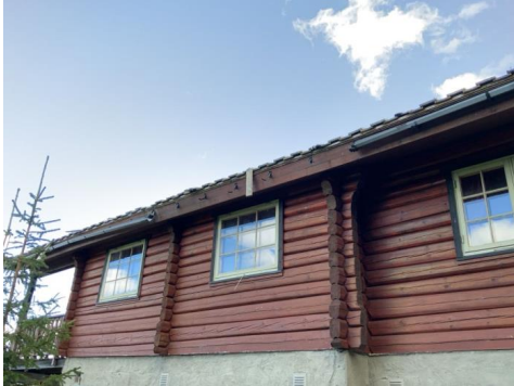
Det er store deformasjoner i renner og nedløp.
