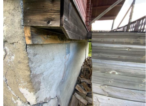
Synlig svank på gavlvegg.
