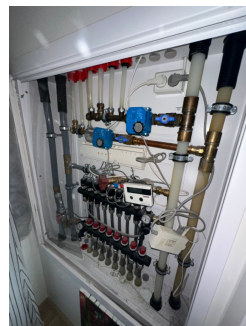
Samleskap med rørkurser og stoppekraner
