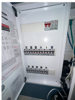
Sikringsskap med automatsikringer.
