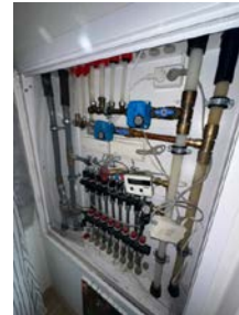
Samleskap med rørkurser og stoppekraner
