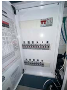
Sikringsskap med automatsikringer.
