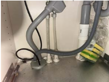
Røropplegg i kjøkkenbenk med Waterguard
