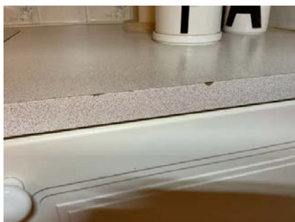
Slittasje/skade på kjøkken.
