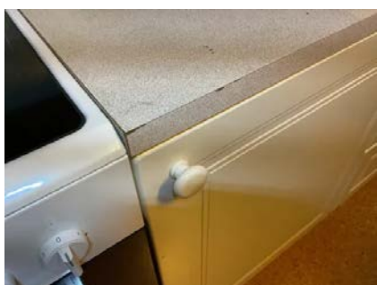
Slittasje/skade på kjøkken.
