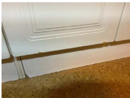
Slittasje/skade på kjøkken.
