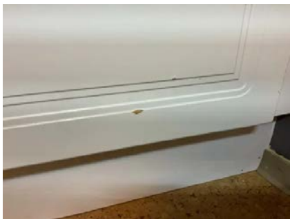
Slittasje/skade på kjøkken.
