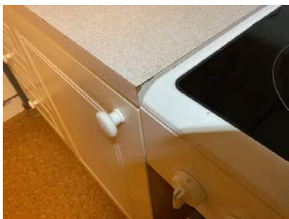
Slittasje/skade på kjøkken.
