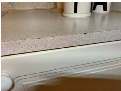
Slittasje/skade på kjøkken.
