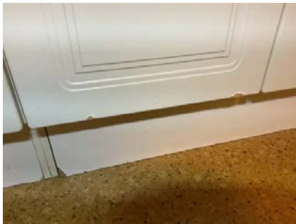
Slittasje/skade på kjøkken.
