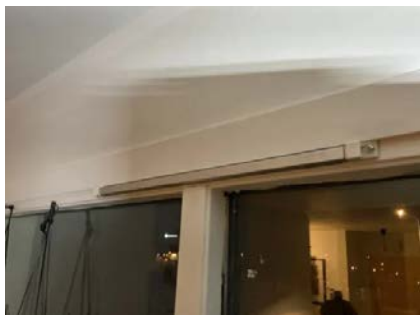
Ventil i vinduer.
