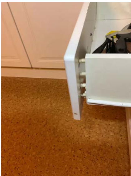
Slittasje/skade på kjøkken.
