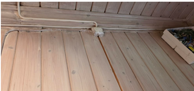
Bilde 3 Yttergang. Utsparringer i boks. Bør byttes.
