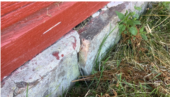
Riss og forskyvning tyder på bevegelse.
