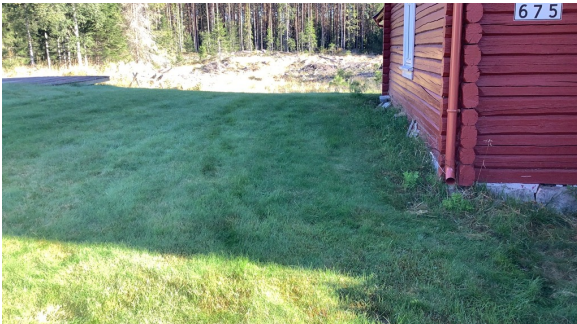
Utilfredsstillende fall fra bygning.
