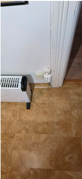
Bilde 2 Til info. Bryter til Bereder og pumpe plassert ved gulv. Kan være utsatt for skade. Hadde vært bedre og entwn fjerne eller plassere høyere på vegg.
