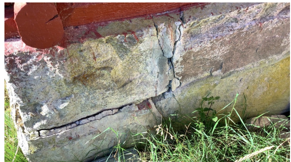
Riss i mørtel tyder på bevegelse.
