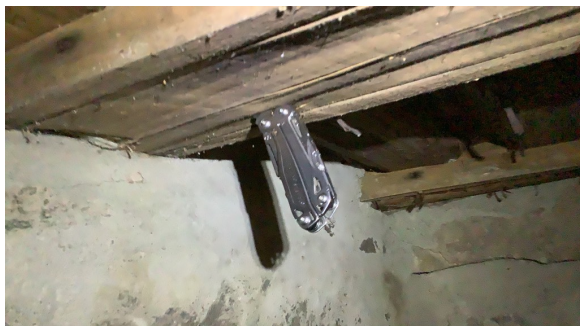
Råteskadet gulvbjelke i kjeller under kjøkken.
