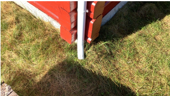
Mangelfull bortledning av takvann.
