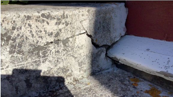
Sprekkdannelse i betongtrapp.
