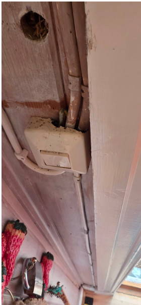
Bilde 1 Bryter i yttergang har store utsparringer og bør byttes.
