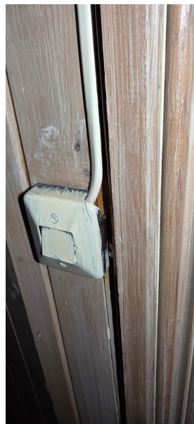
Bilde 4 Bryter har sprekk og stor utsparring. Bør byttes.
