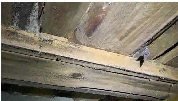
Tidligere sopp utvikling og råteskader i gulvbjelke.
