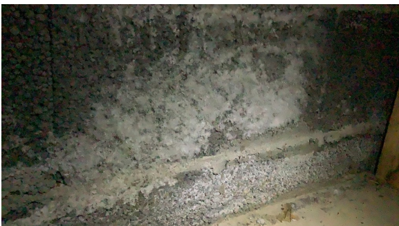
Saltutslag på mur.
