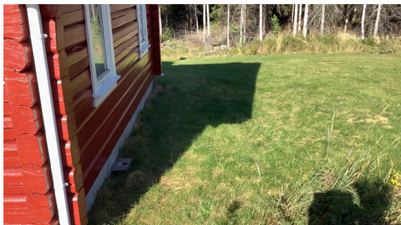
Utilfredsstillende fall fra bygning.
