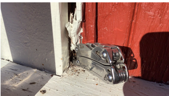
Råteskadet bærende trestolpe på inngangsparti.
