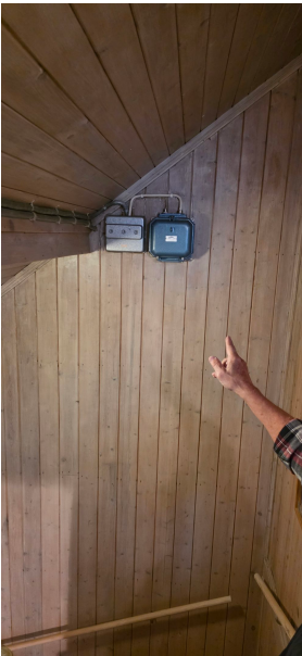
Bilde 1 Inntaksikringer er vanskelig tilgjengelig. Så ble ikke inspisert. Det er anbefalt å bytte til knivsikringer som ikke trenger årlig tiltrekking.
