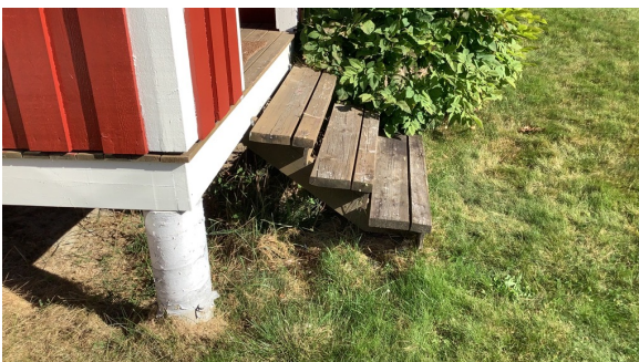
Trapp mangler rekkverk på en side.
