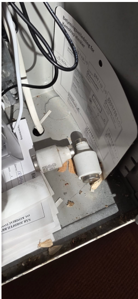
Bilde 1 Hull i tavle må tettes
