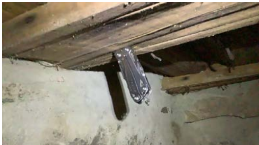
Råteskadet gulvbjelke i kjeller under kjøkken.
