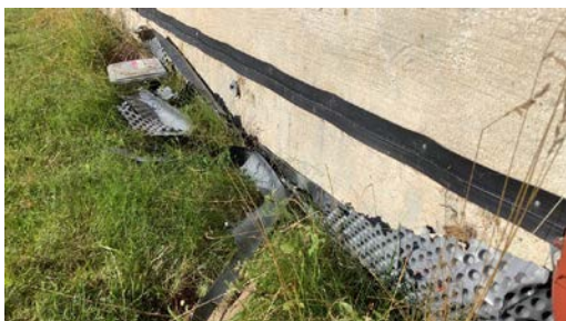
Fuktsperre har løsnet fra ringmur.
