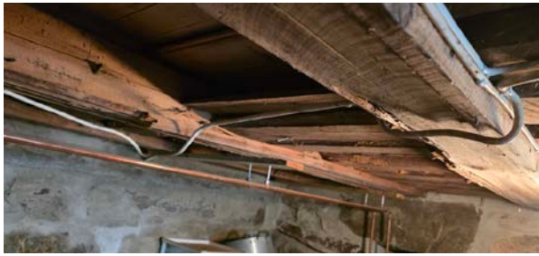
Bilde 1 Ledning henger løs i kjeller under kjøkken.
