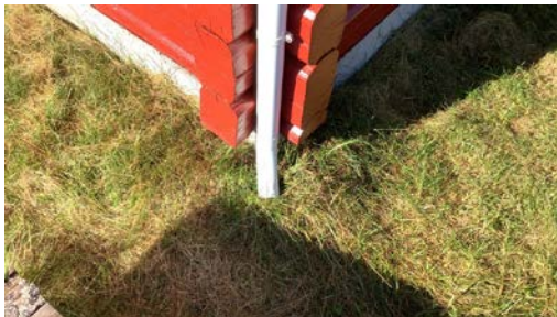
Mangelfull bortledning av takvann.
