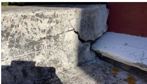
Sprekkdannelse i betongtrapp.
