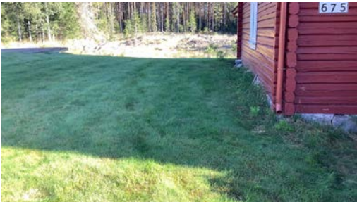
Utilfredsstillende fall fra bygning.
