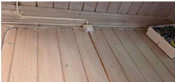
Bilde 3 Yttergang. Utsparringer i boks. Bør byttes.
