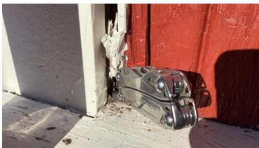
Råteskadet bærende trestolpe på inngangsparti.
