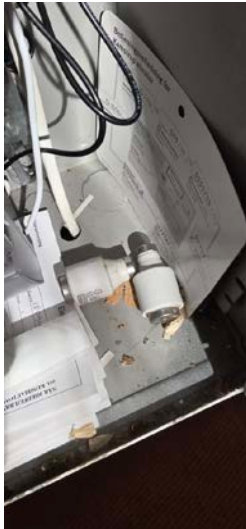
Bilde 1 Hull i tavle må tettes
