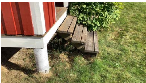
Trapp mangler rekkverk på en side.
