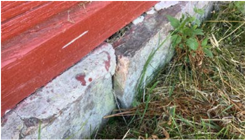
Riss og forskyvning tyder på bevegelse.
