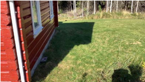
Utilfredsstillende fall fra bygning.
