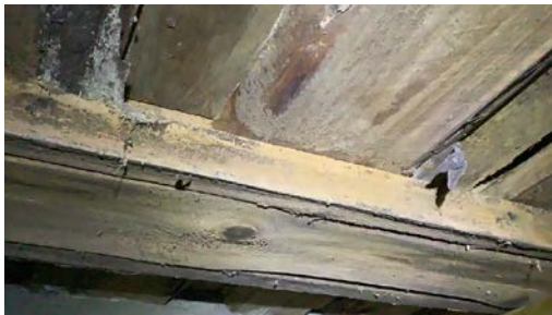
Tidligere sopputvikling og råteskader i gulvbjelke.
