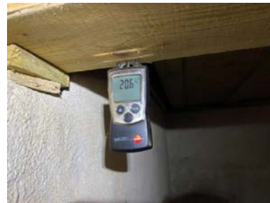
Det måles skadelig fuktinnhold i bjelkelag på tilbygg.
