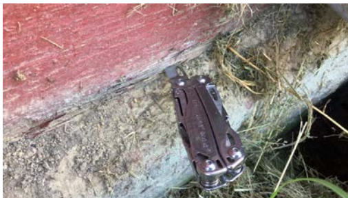
Eksempel på råteskade i bunnen av bunnstokk der ringmur har fall mot tømmer.
