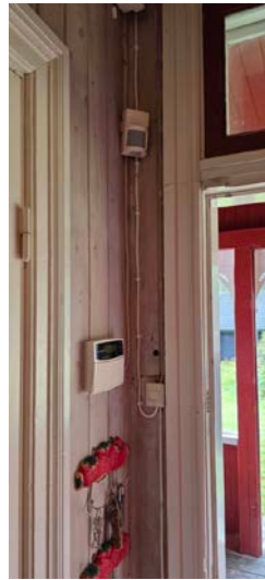
Bilde 2 Det ligger også pmh kabel til innbruddsalarm. Kabel ernikke ment for fast installasjon . Alarm er defekt og kan fjernes og bryter byttes. Se punkt over.
