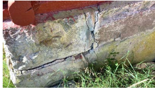
Riss i mørtel tyder på bevegelse.
