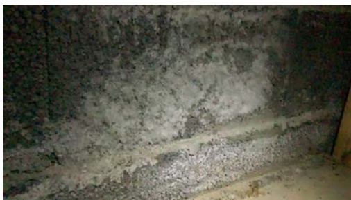
Saltutslag på mur.
