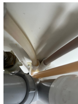
Manglende tettemuffer på varerør.
