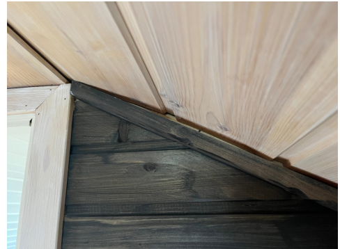
Eksempel på ikke faglig utførsel av listing.
