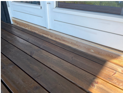
Terrassedør mangler beslag under.
