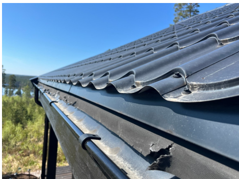
Takfotbeslag mot sør er montert feil.
