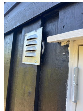
Gjennomføring av ventil må utbedres.
