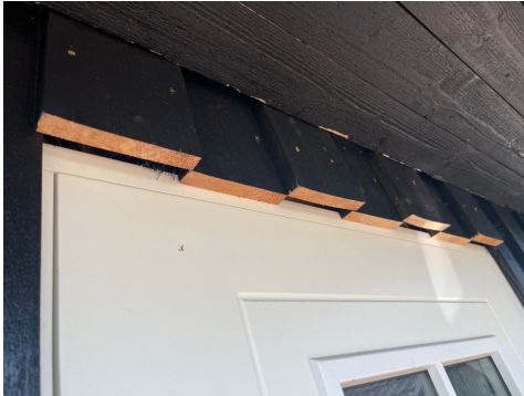
Ikke faglig utført løsning over ytterdør.
