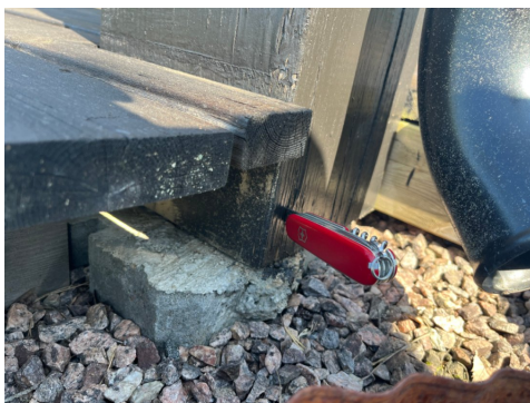
Råte i nedkant av søyler.
