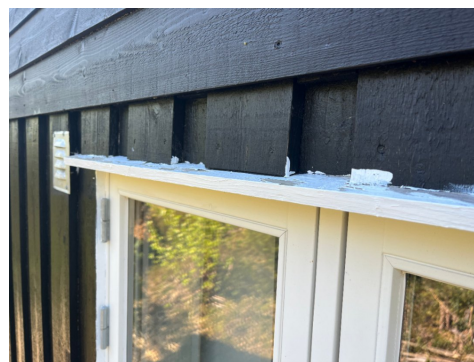
Det er ikke synlig beslag eller tetting over vinduer.
