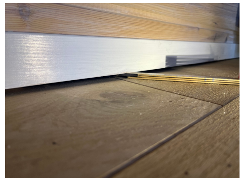
Glippe mellom gulvlist og gulv.
