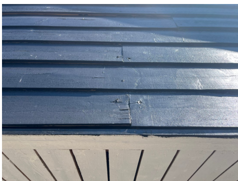
Skjøter og innfesting av kledning er ikke faglig utført.
