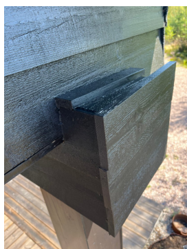
Løsning i enden av drager må utbedres.
