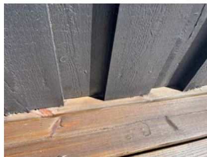
Kledning er ført ned til terrassebord.
