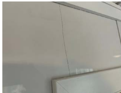
Sprekk i veggflis over dør.
