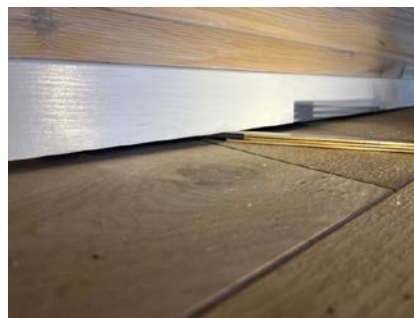
Glippe mellom gulvlist og gulv.
