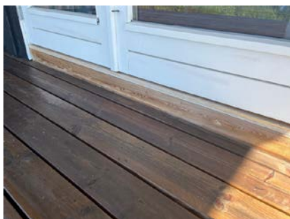
Terrassedør mangler beslag under.
