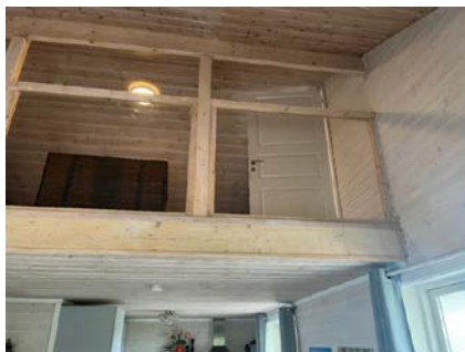
Kantbjelke er synlig og ikke kledd med panel.
