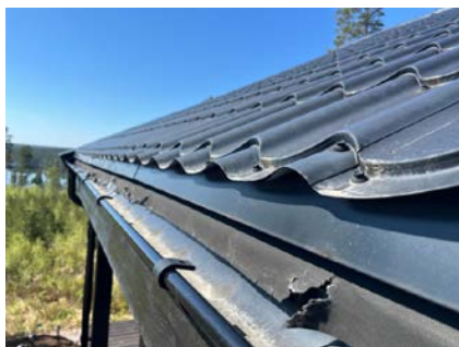
Takfotbeslag mot sør er montert feil.
