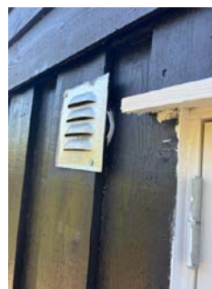
Gjennomføring av ventil må utbedres.
