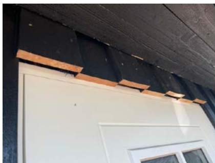
Ikke faglig utført løsnings over ytterdør.
