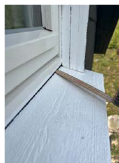
Vannbrett under vinduer i hems/loftetasje er ikke tette.
