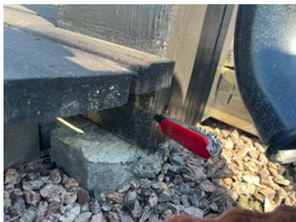
Råte i nedkant av søyler.
