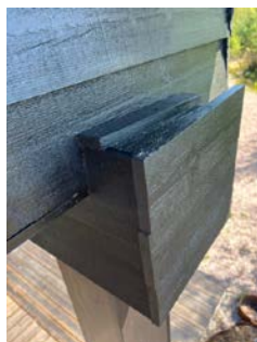
Løsning i enden av drager må utbedres.
