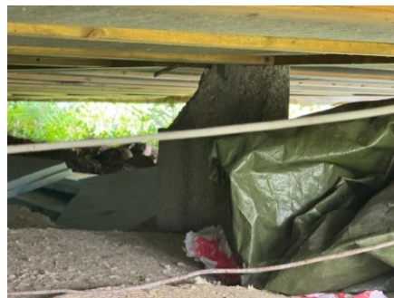
Avskallinger og skjevhet i pilar under stue.
