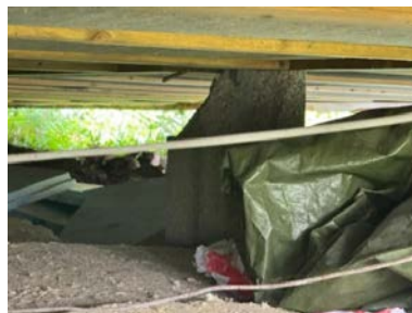
Avskallinger og skjevhet i pilar under stue.
