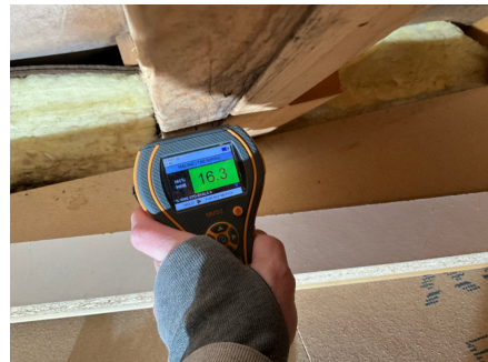
Fuktmerker i deler av undertaket.
