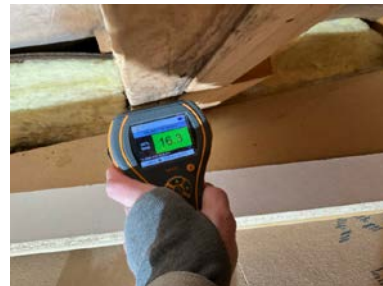
Fuktmerker i deler av undertaket.
