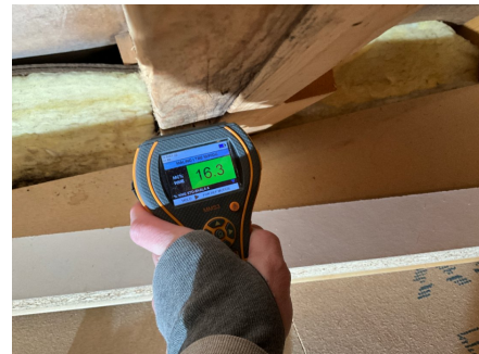
Fuktmerker i deler av undertaket.
